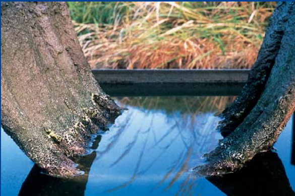
Cable tray under extreme weather conditions - varying water level. Kabeltrasse unter härtesten Bedingungen - wechselnder Wasserstand.
